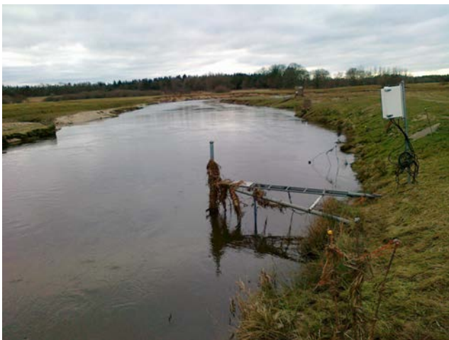
Fig. 5. Eksempel på opsætning af ADH sensorer på et stativ ved vandløbskanten, Skjern å.
